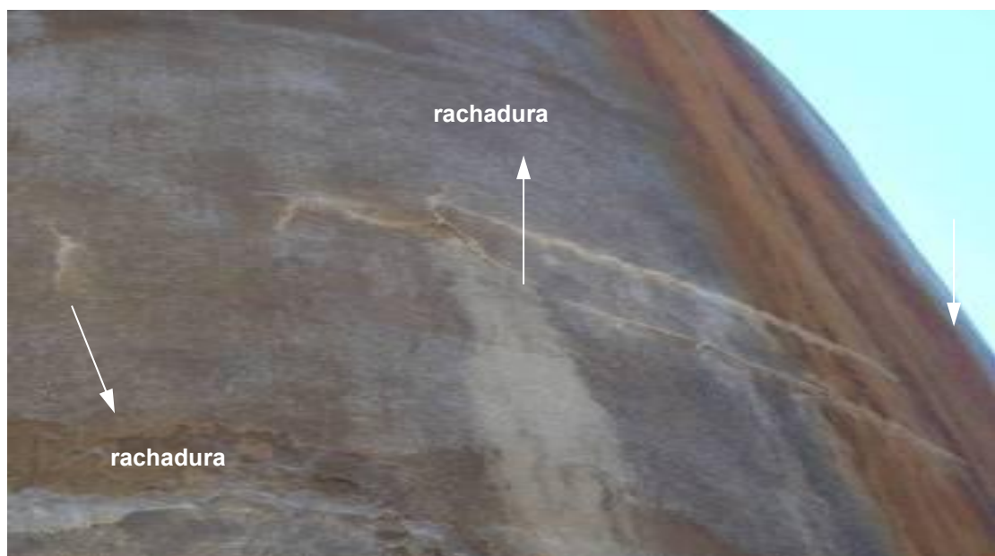
Figura.2 Mostra rachaduras horizontais e verticais no costado. As rachaduras são passantes, isto é, atravessam a parede do costado.
