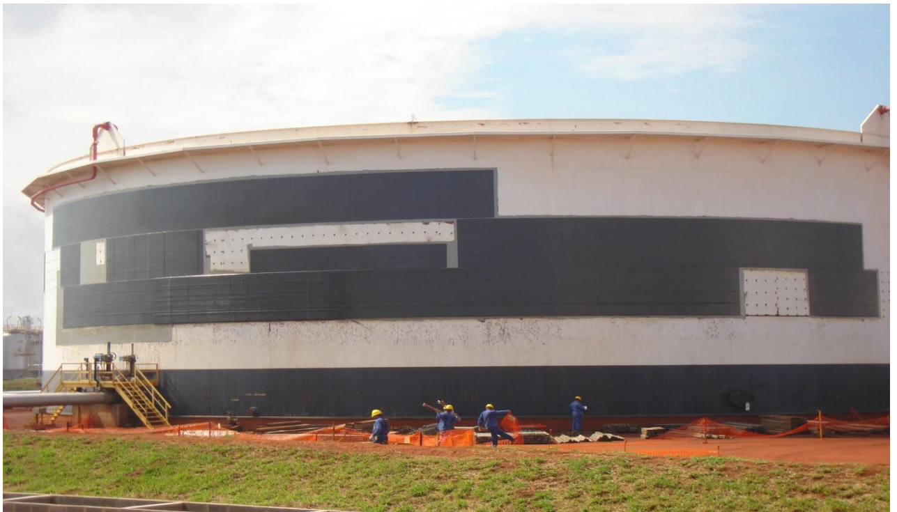
Apenas os locais corroídos foram reabilitados. A espessura do reforço varia conforme a necessidade. Foto cedida pela Petrobras.
