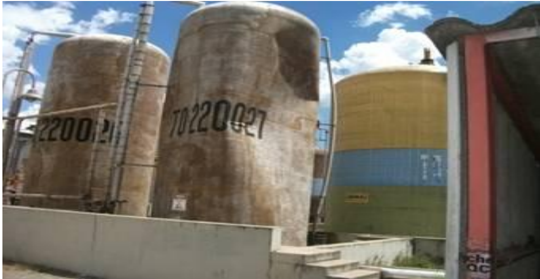
Figura 1 Mostra o tanque de formol, colapsado por vácuo.
