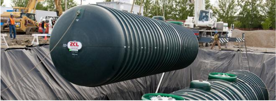
Os tanques enterrados usados para armazenar combustíveis são feitos com parede dupla.
