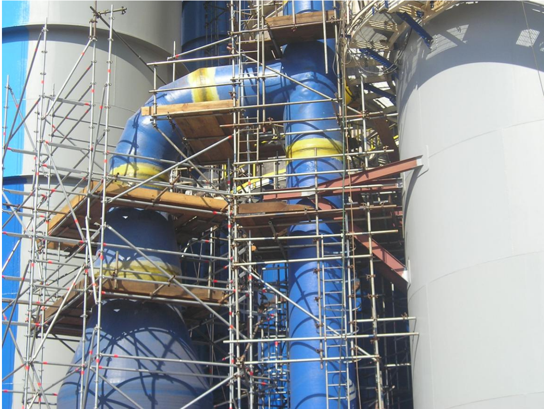
Torre de branqueamento de celulose montada no campo. As emendas foram feitas com uniões laminadas, mostradas na cor amarela. Foto cedida pela FGS, divisão NOV.
